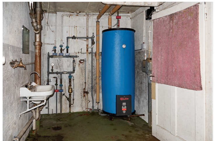
Img.18 : N°83C - Sous-sol / Local chauffage
