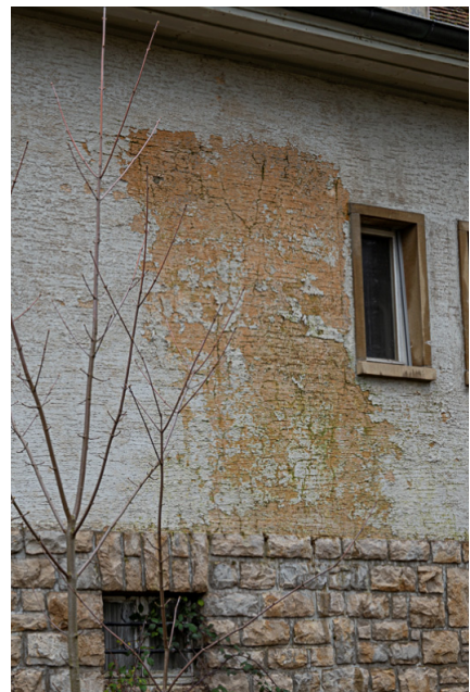
Img.88 : N°83C - Secteur Est / Dégradation façade
