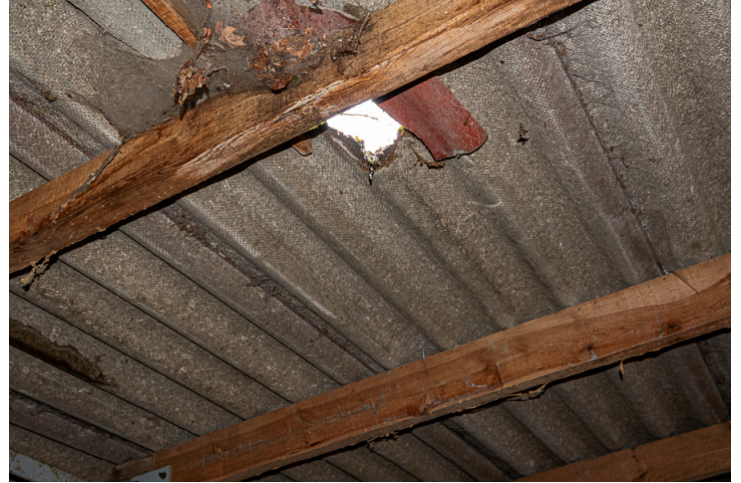
Img.104 : N°83G / Réduit Est (toiture dégradée)
