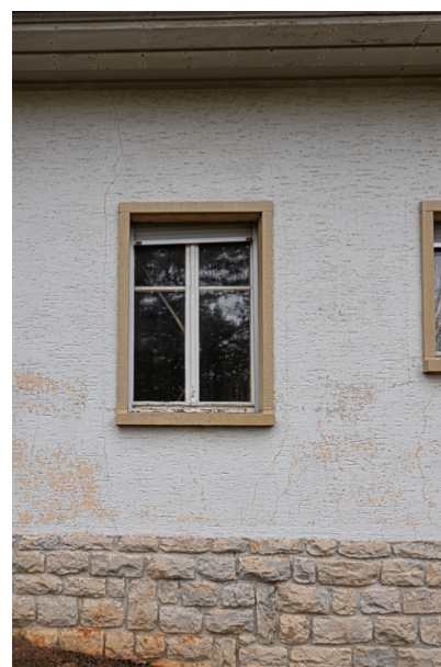
Img.70 : N°83C - Secteur Ouest / Multiples fissures verticales en façade
