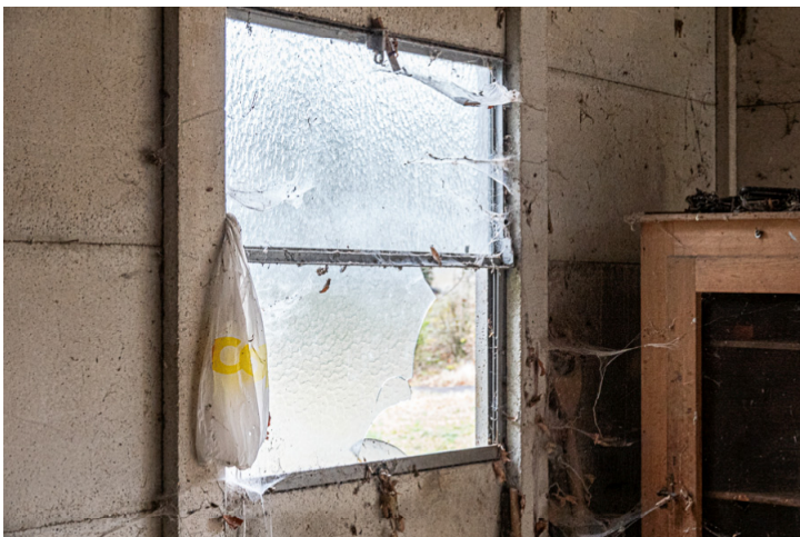
Img.107 : N°83G / Garage Sud ; vitrage cassé
