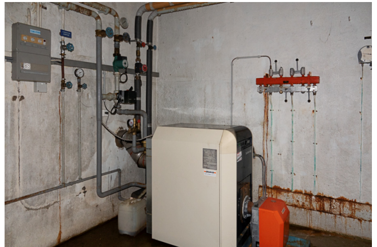
Img.16 : N°83C - Sous-sol / Local chauffage
