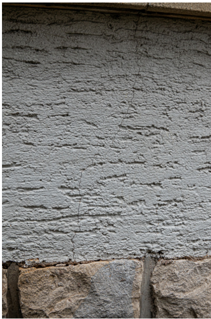
Img.85 : N°83C - Secteur Sud / Multiples fissures verticales
