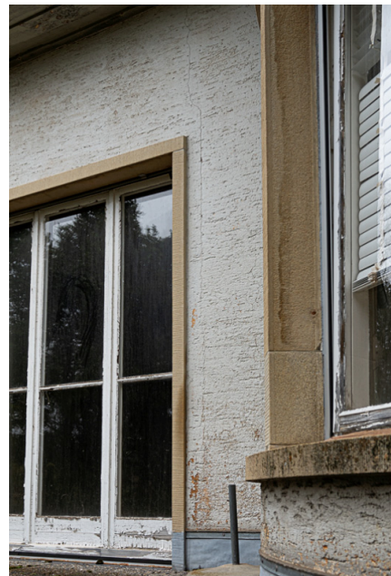
Img.84 : N°83C - Secteur Sud / Multiples fissures verticales
