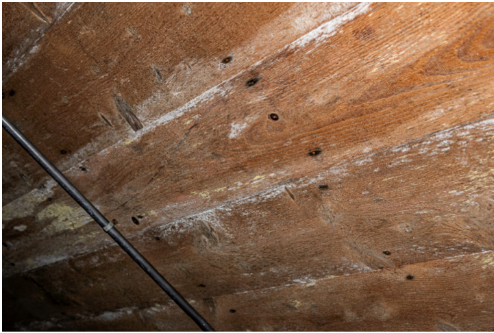
Img.51 : N°83C - ET1 / Efflorescences sur lames bois (combles)
