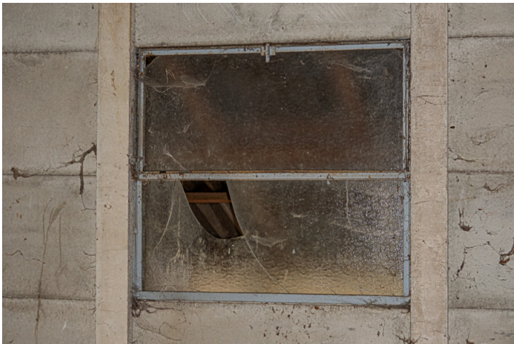
Img.105 : N°83G / Réduit Est (vitrage cassé)
