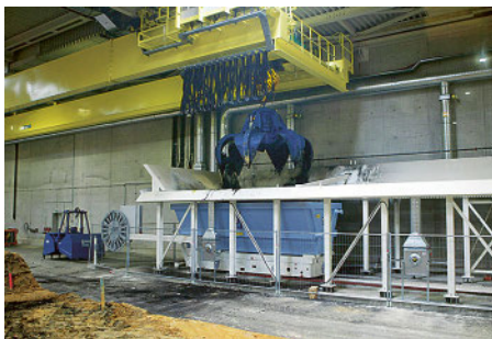
Assainissement de la décharge industrielle de Bonfol (JU) à l'intérieur d'une halle hermétiquement fermée.
