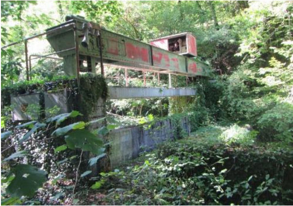
Figure 1.6 Vanne de régulation à l'entrée du canal
