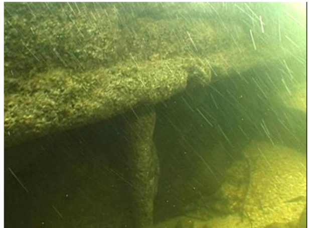
Figure 1.5 Photo subaquatique de l'affouillement sous la semelle en béton. Source : Aquarius Sàrl.
