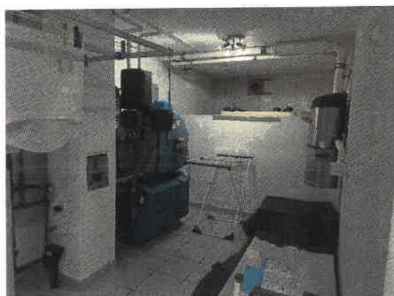
Sous-sol – buanderie avec installations techniques
