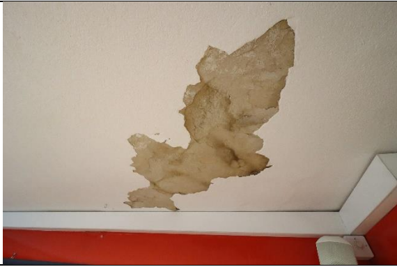
057_Infiltration Bar - Gare 17
