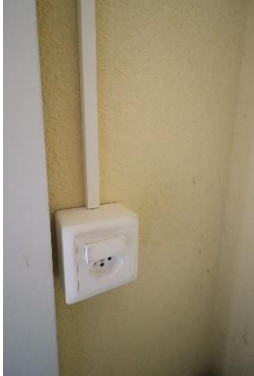
071_Dépôt - Magasin - Gare 17
