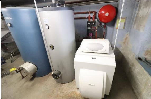
091_Local chauffage - Gare 17
