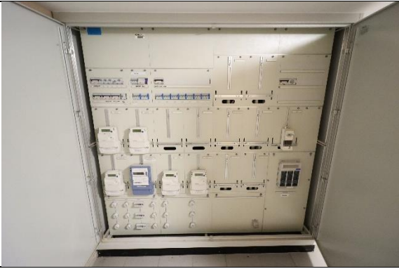
177_Tableau électrique - Gare 17
