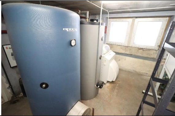
089_Local chauffage - Gare 17
