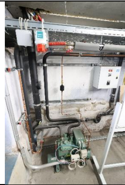
090_Local chauffage - Gare 17
