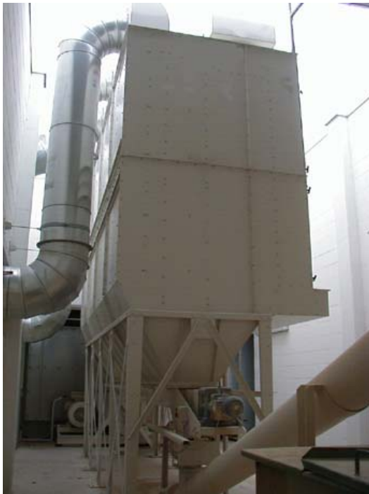
Fig. 6: Exemple d'une installation de filtration sous la forme d'un filtre continu
