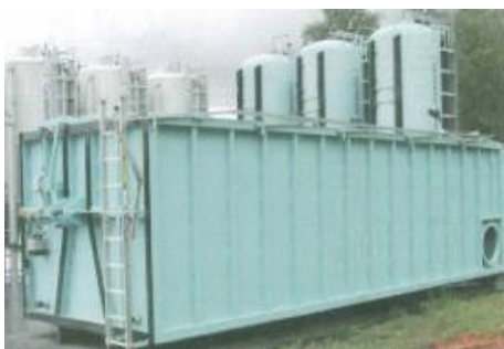
Fig. 10: Exemple d'adsorbeur à charbon actif, exécution en forme de container
