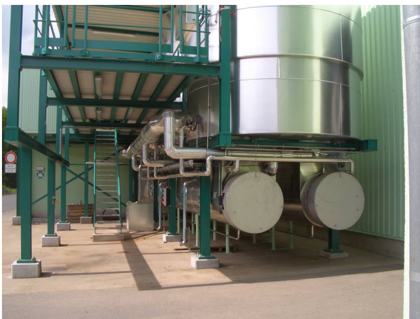
Fig. 9: Exemple de réalisation : Vue des conduites d'air pollué et traité, PCR
