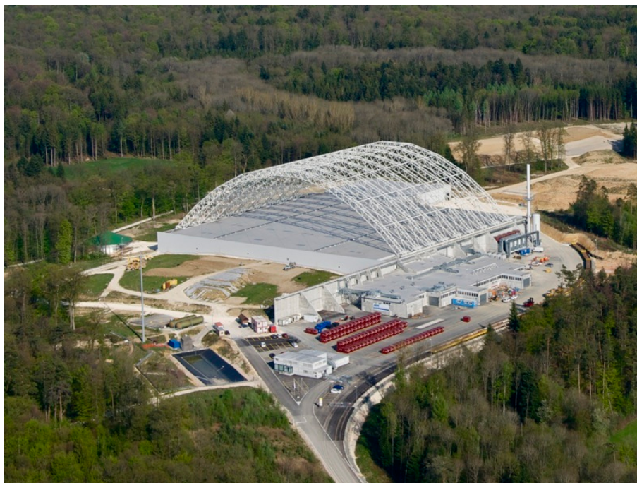
Figure 1: Halle d'excavation construite sur le site de la décharge industrielle de Bonfol. bci Betriebs-AG est responsable de la planification et de la mise en œuvre de l'assainissement de la décharge. Elle est mandatée par les entreprises de la Basler Chemische Industrie .
