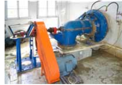
Doux. Microcentrale du torrent
