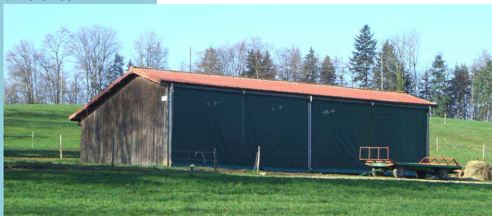
Figure 23: Utilisation de filet coupe-vent comme paroi ventilée (Saulcy)
