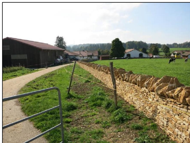
La Chaux-des-Breuleux. Rénovation d'un mur en pierres sèches dans le cadre du PGI avec le concours de l'EFEJ à Bassecourt
