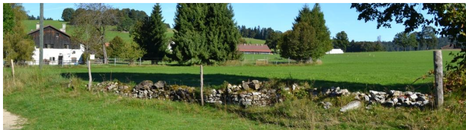
Figure 3 : Mur de pierres sèches envahi par la végétation (Muriaux)
