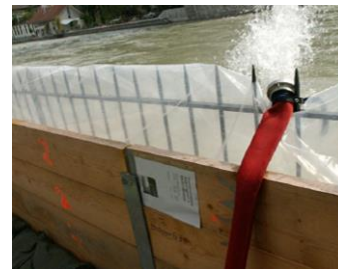
Matériel préparé dans le cadre du plan d'alarme et d'intervention. Source : AEAI/OFEG 2004, « Aide à la décision protection mobile contre les inondations ».
