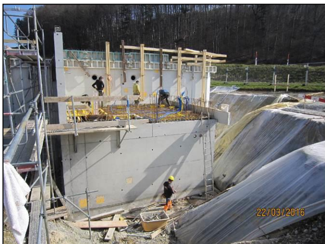
Syndicat des eaux du Val-Terbi. Nouveau réservoir central.
