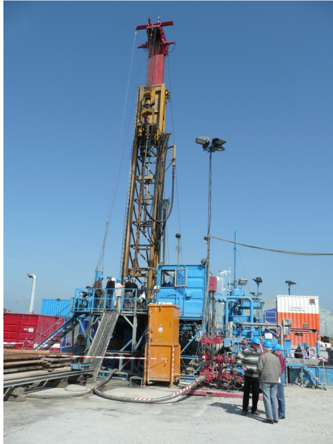
Figure 13 : Foreuse Wirth B12 (charge maximale 152 T) à Schlattigen (TG), avril 2011. Exploration géothermique, profondeur atteinte 1508 m (Photo O. Zingg)
