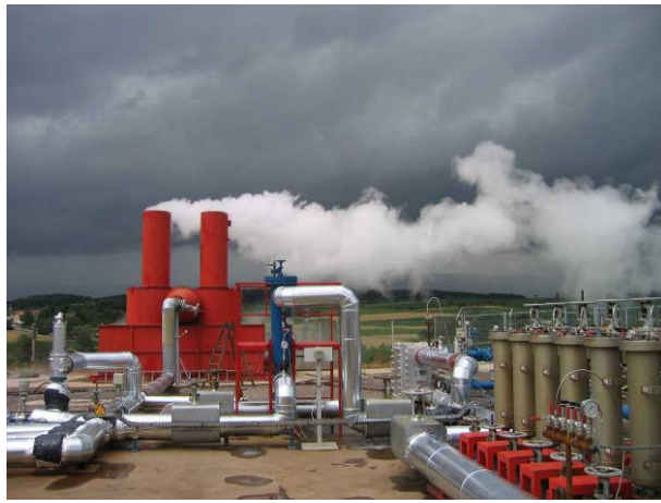
Figure 33 : Tests de circulation du réservoir de Soultz-sous-Forêts (source www.geothermie-soultz.fr/v )
