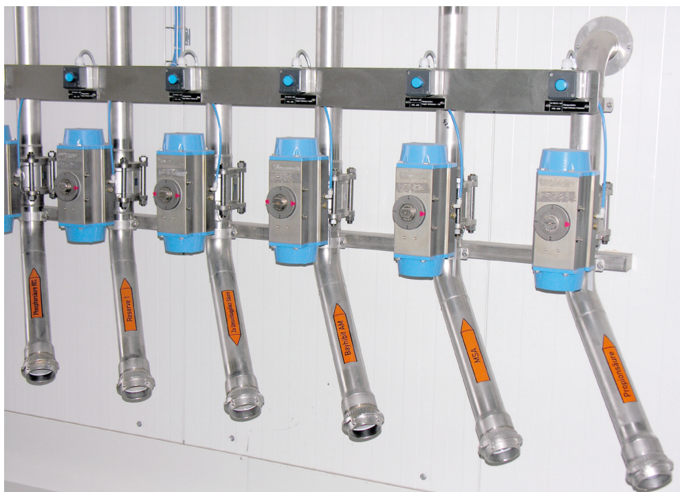
Figure 6 Poste de remplissage de citernes fixes (Entreprise Halag, canton de Thurgovie)
