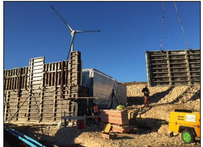
St-Brais-Sceut. Nouveau réservoir à St-Brais.
