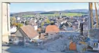
La réfection du mur a permis cette découverte.
