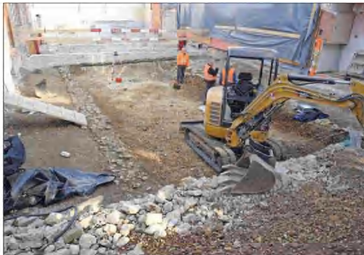
On voit à gauche un mur en pierres qui faisait partie des fondations de la villa romaine de Courroux.
