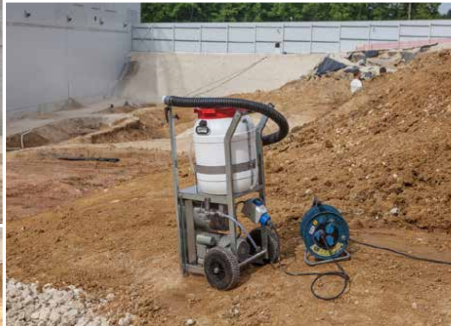
Dispositif mobile d'aspersion (traitement de l'air ambiant)
