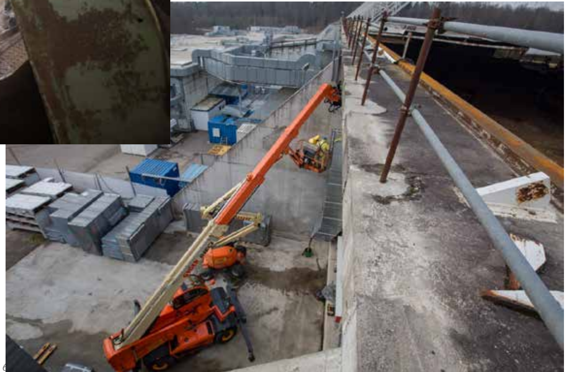
Février / mars 2017: démontage canaux de ventilation et installation de traitement de l'air
