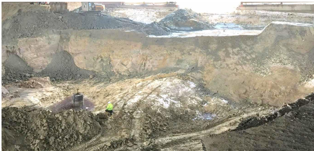
Lentille sableuse nord : mise en place d'un drainage pour capter les eaux contaminées
