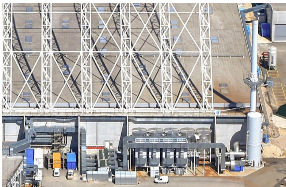
L'installation de traitement de l'air a traité l'air vicié des trois halles dans trois étapes. Des contrôles à la cheminée ont démontré le respect de l'OPair (photo aérienne de 2013)
