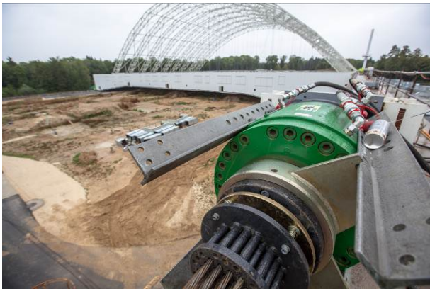
Déplacement de la halle : un des vérins hydrauliques est installé sur le mur de l'axe ouest. La halle est tirée par pas de 10 cm vers sa position nord.
