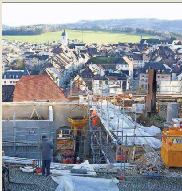
Les travaux d'assainissement du mur de soutènement du château de Porrentruy ont commencé en 2017.
