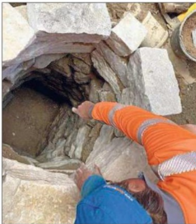
Des ouvriers sont en train de reconstruire le haut du puits avec des pierres calcaires. PHOTO HD
