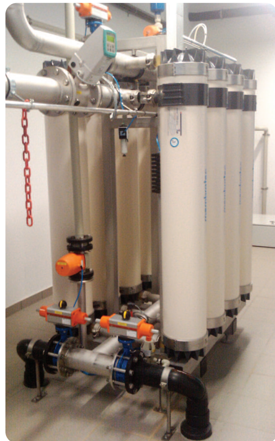
Certaines eaux captées dans le Jura font déjà l'objet de traitements complexes adaptés à une qualité d'eau brute problématique (ici une station d'ultrafiltration).
