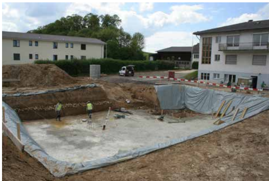
Fig. 2.21 Alle – Oeuches Domont. Le terrassement profond vu depuis l'est, avec la voie romaine en cours de dégagement dans la coupe 1. La base de l'excavation est déjà recouverte d'un béton maigre d'assainissement. Photo P.-A. Borgeaud, OCC-SAP
