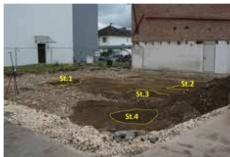
Fig. 2.80 (à gauche) Courroux – Rue du 23-Juin. La parcelle après déconstruction vue depuis le sud-est. Photo P.-A. Borgeaud, OCC-SAP
