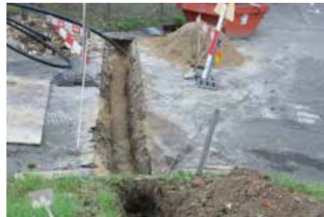
Fig. 2.150 (à gauche) Porrentruy – Parc Mouche/Le Château. La tranchée de traversée du chemin vue depuis le nord-ouest. En arrière-plan, la porte de nos locaux dans les caves du château. Photo P.-A. Borgeaud, OCC-SAP
