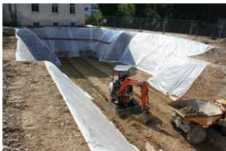
Fig. 2.174 (à gauche) Porrentruy – Dépôts Wardeck. Vue de la fosse à citernes pratiquement terminée. Photo P.-A. Borgeaud, OCC-SAP
