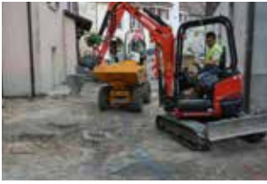
Fig. 2.208 Saint-Ursanne – rue Basse. Vue des premiers coups de pelle dans la rue Basse, après l'enlèvement des pavés. Photo P.-A. Borgeaud, OCC-SAP
