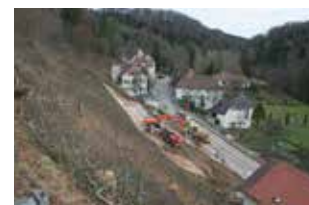
Fig. 2.147 Pleigne – Lucelle. Les travaux vus depuis la route de Charmoille. Photo P.-A. Borgeaud, OCC-SAP
