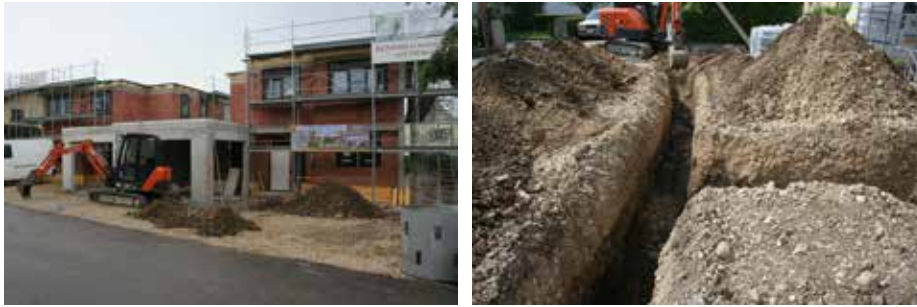
Fig. 2.66 (à gauche) Courroux – Rue des Romains. Les deux « villas Cubo » en cours de construction, devant lesquelles vont être creusées les canalisations.
