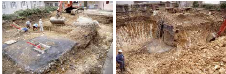
Fig. 3.20 (à droite) Porrentruy – Hôtel-Dieu. Le terrassement ultérieur de l'abri des biens culturels a complètement éventré l'ancienne cave dont on voit ici encore la dalle de sol, la paroi septentrionale et le passage d'accès à l'escalier. On voit également la trappe carrée de la citerne, à droite du sommet de l'échelle. Photo P.-A. Borgeaud, OCC-SAP
