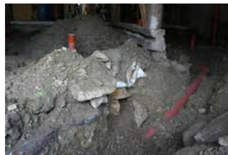
Fig. 2.6 (à gauche) Cornol – Route des Rangiers. L'état du sol le 31 mars 2016. Photo P.-A. Borgeaud, OCC-SAP
