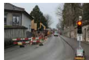
Fig. 2.177 Porrentruy – Thermoréseau. Les travaux de la route de Bure vus depuis l'est. Photo P.-A. Borgeaud, OCC-SAP
