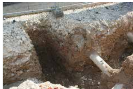
Fig. 2.195 (à droite) Porrentruy – rue du Gravier. La tranchée au sud du rond-point. Photo P.-A. Borgeaud, OCC-SAP
