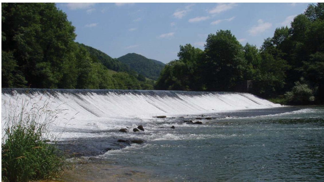
Seuil de Bellefontaine. Barrage d'une hauteur de 7 m et d'une largeur de 85 m totalement infranchissable pour l'apron.
