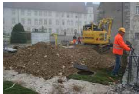
Fig. 2.246 (à gauche) Porrentruy – Château. Le mur de soutènement de l'esplanade menaçant de s'effondrer. Photo P.-A. Borgeaud, OCC-SAP
