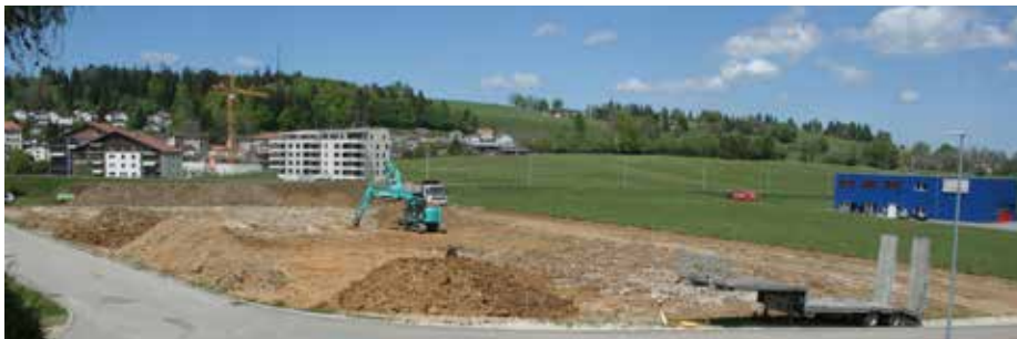
Fig. 2.206 Saignelégier – Sur la Courbe Roye. La parcelle 1269 en cours de terrassement vue depuis le sud. Photo P.-A. Borgeaud, OCC-SAP
