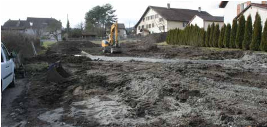
Fig. 2.110 Develier – Clos de la Betteratte. Le chantier vu depuis l'est. Photo P.-A. Borgeaud, OCC-SAP
