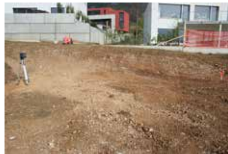
Fig. 2.106 (à gauche) Delémont – Chemin des Adelles. Vue du terrassement terminé dans la parcelle 4018. Photo P.-A. Borgeaud, OCC-SAP
