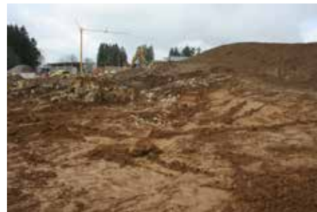
Fig. 2.150 (à gauche) Le Noirmont – La Calame. La surface en cours de terrassement vue depuis l'est. Photo P.-A. Borgeaud, OCC-SAP
