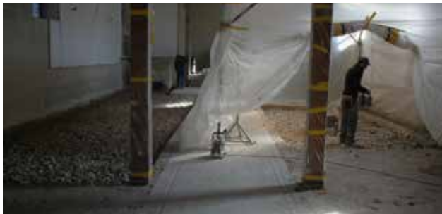
Fig. 2.233 Vermes – Église. Démontage des dalles latérales en béton maigre qui supportaient les bancs. Photo P.-A. Borgeaud, OCC-SAP
