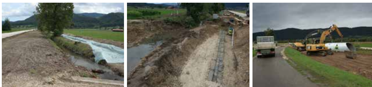
Fig. 2.100 (à gauche) Courroux – Canal de Bellevie. Le ruisseau provisoire vu depuis le nord-ouest.
