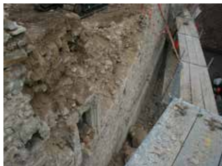
Fig. 2.274 (à gauche) Porrentruy – Château. Début du démontage mécanique du mur de soutènement st. 8. Photo P.-A. Borgeaud, OCC-SAP
