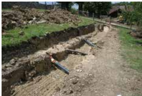
Fig. 2.74 (à gauche) Courchapoix – Es Bellieges. La tranchée vue depuis l'ouest, avec une partie des nombreuses conduites rencontrées et réparées sous l'église. Photo P.-A. Borgeaud, OCC-SAP
