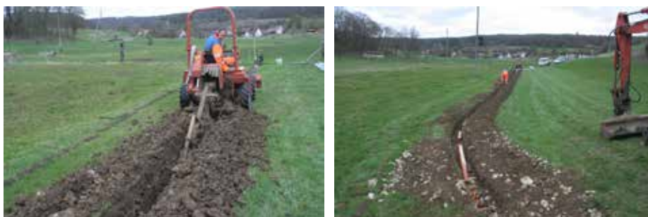
Fig. 2.32 (à gauche) Beurnevésin – Es Breuyes. Vue de la tranchée en cours de creusage à la fraise. Photo P.-A. Borgeaud, OCC-SAP
