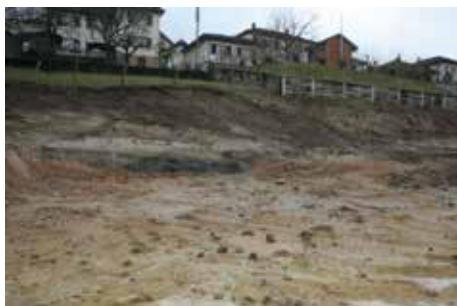
Fig. 2.45 (à droite) Courfaivre – Derrière le Vieux Môtier. Vue du début de la construction depuis l'ouest. Photo P.-A. Borgeaud, OCC-SAP
