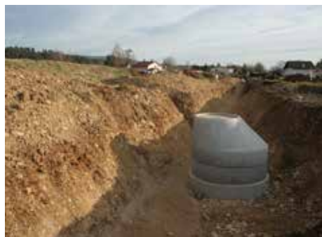
Fig. 2.16 (à gauche) Bassecourt – Les Longues Royes. Vue d’une tranchée de canalisation. Photo P.-A. Borgeaud, OCC-SAP
