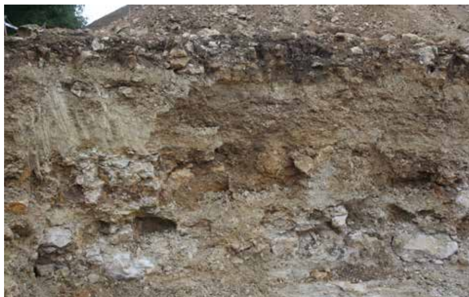
Fig. 2.4 Alle – Sur les Vies de Bâle. Détail des niveaux de roche dans la coupe nord du terrassement profond. Photo P.-A. Borgeaud, OCC- SAP
