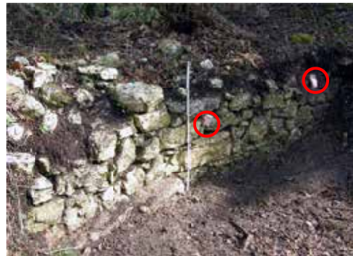
Abb. 4: Mauer Pos. 11 mit regelmässigen Lagen aus lokal anstehenden Rauracien-Kalken. Die Mauer steht direkt auf dem anstehenden Felsen (links unten).
