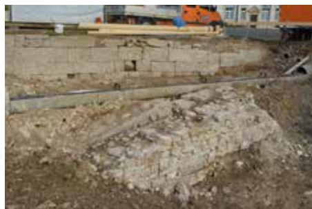
Fig. 2.258 (à droite) Porrentruy – Château. Le mur st. 4 s'appuie contre la tour du Trésor st. 9. Photo P.-A. Borgeaud, OCC-SAP
