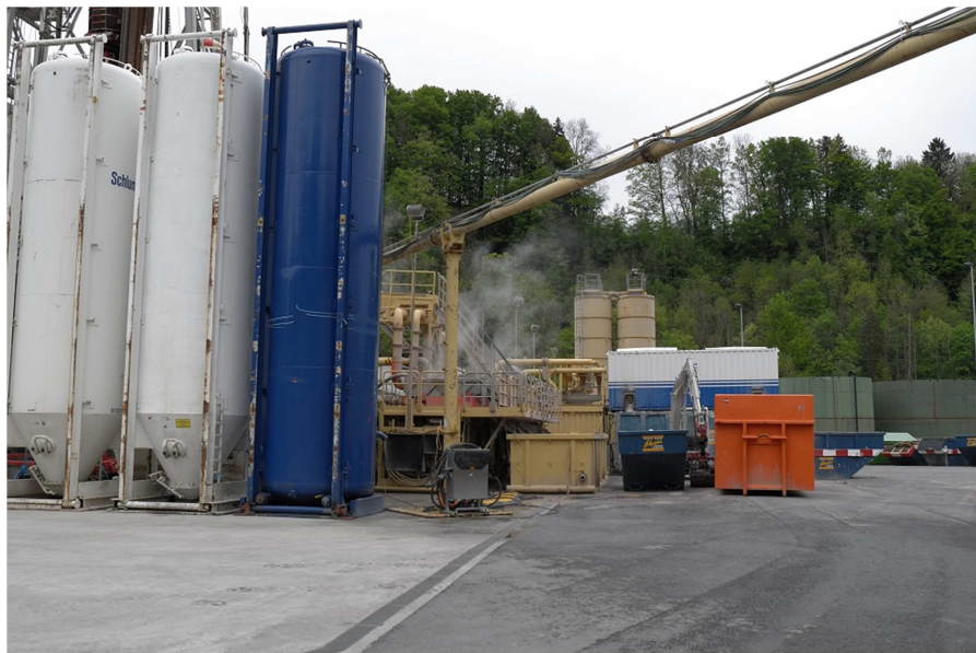
Figure 31 Exemple d'agencement de la place de forage "intérieure" avec l'installation de forage, le système de traitement des boues, les bennes de récolte des matériaux solides et les silos pour le stockage des boues.
