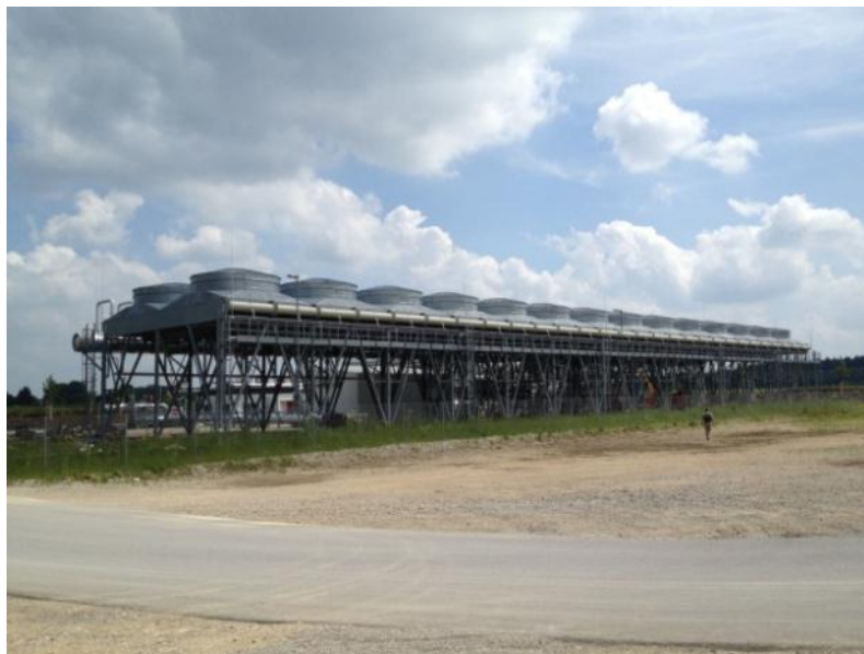
Figure 4-3 : Photo des aérorefroidisseurs installés pour la centrale de Dürrnhaar en Allemagne. (Source : photo CSD)
