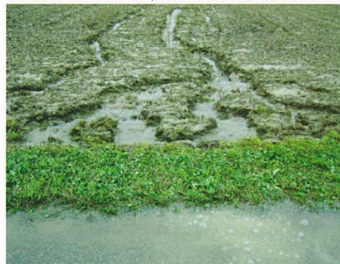
Ravines formées par les écoulements d'eau météorique d'une route.
