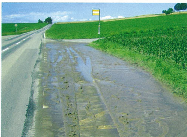
Un arrêt de car postal souillé par l'érosion.
