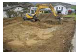
Fig. 2.150 Vicques – En Chaipelat. Le terrassement vu depuis l'ouest. Photo P.-A. Borgeaud, OCC-SAP
