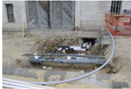
Fig. 2.194 (à gauche) Porrentruy – Diverses rues. La tranchée dans la rue du Gravier vue depuis le sud. Photo P.-A. Borgeaud, OCC-SAP
