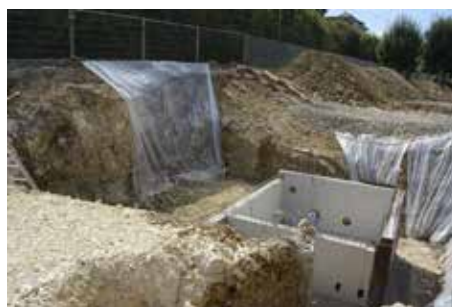
Fig. 2.191 (à gauche) Porrentruy – Chemin des Bains. Bancs de roche massive au sud de la piscine. Photo P.-A. Borgeaud, OCC-SAP
