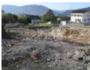
Fig. 2.16 Boécourt – Route Principale. Le terrassement vu depuis le nord. Photo P.-A. Borgeaud, OCC-SAP
