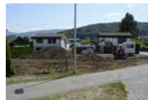
Fig. 2.99 Develier – Dos Cré. La parcelle en cours de terrassement, vue depuis le nord. Photo P.-A. Borgeaud, OCC-SAP
