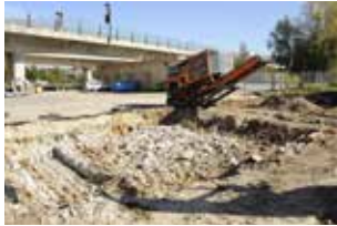
Fig. 2.183 Porrentruy – La Rasse. Les surfaces déconstruites vues depuis le sud-ouest. Photo P.-A. Borgeaud, OCC-SAP
