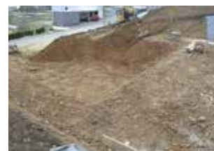
Fig. 2.26 Chevezey – Grand Pré. Le terrassement vu depuis le nord-est. Photo P.-A. Borgeaud, OCC-SAP
