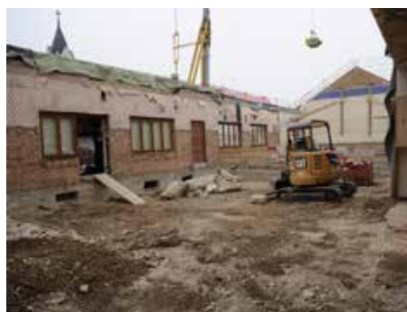
Fig. 2.30 (à droite) Courroux – Le Raisin. Les caves de la moitié septentrionale du bâtiment vidé. Au premier plan la citerne à mazout. Photo P.-A. Borgeaud, OCC-SAP
