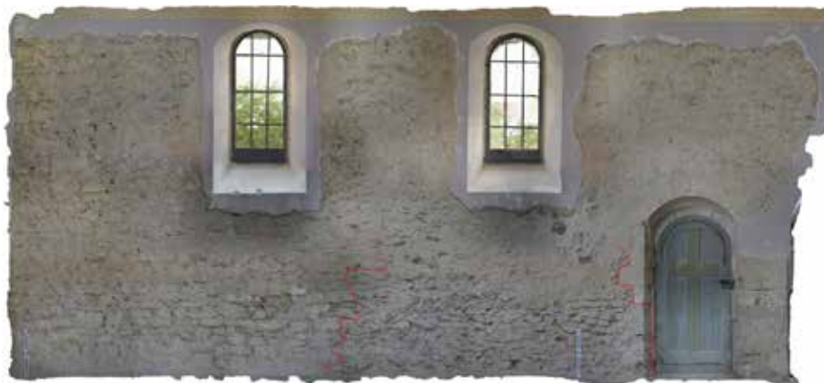
Fig. 2.107 Fontenais – Chapelle Sainte-Croix. Vue intérieure du mur nord. Photogrammétrie P.-A. Borgeaud et Y. Maître, OCC-SAP
