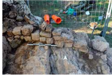
Fig. 9 : le mur nord vu depuis l'intérieur de la chapelle. Seul le parement intérieur est encore observable, le parement extérieur s'étant effondré avec le substrat rocheux calcaire. Photo : Karine Marchand.
