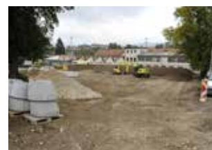
Fig. 2.21 Courfaivre – Rue de la Rauracie. La zone des travaux vue depuis le sud. Photo P.-A. Borgeaud, OCC-SAP
